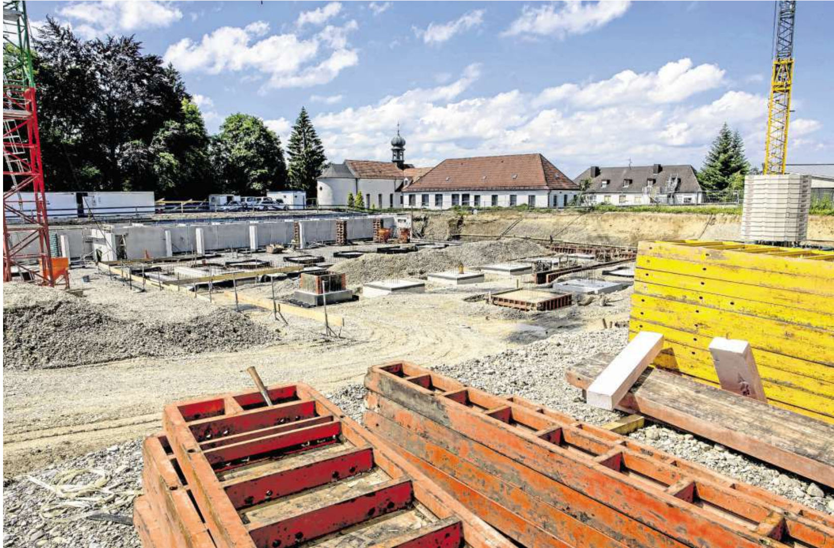
Auf dem ehemaligen Areal der Maria-Ward-Schule in Lenzfried baut die „Brefa Bauunternehmung GmbH“ aus Woringen mehrere Mehrfamilienhäuser, in denen insgesamt fast 60 Wohnungen entstehen. Der Verkauf läuft schon seit Längerem. Fotos: Ralf Lienert
